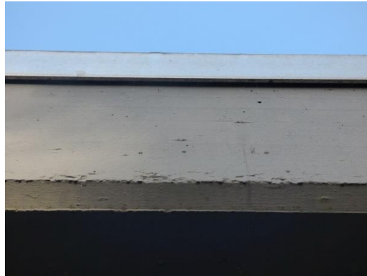
Abb. 25 Spalte hinter Attikaverkleidung.
