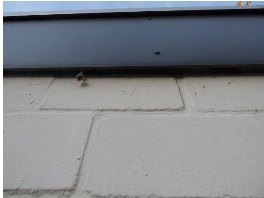
Abb. 31 Spalte hinter der Wandverkleidung.
