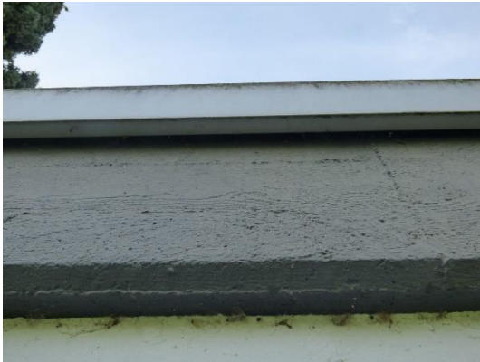
Abb. 33 Spalte hinter Attikaverkleidung an Gebäude 2.
