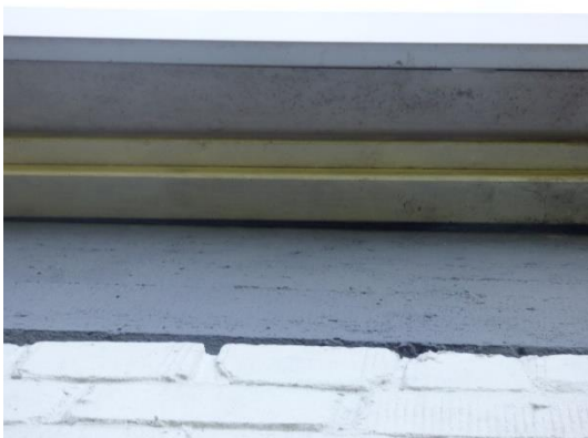
Abb. 35 Spalte am Dachüberstand von Gebäude 2.
