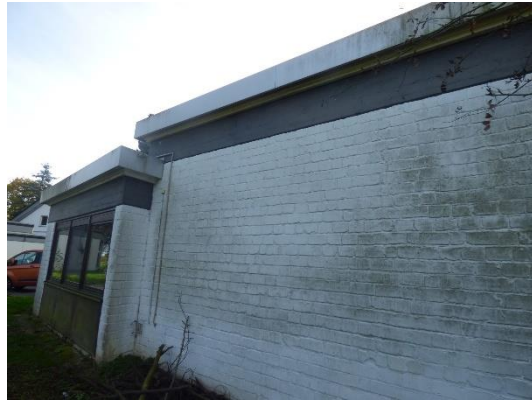
Abb. 34 Dachüberstand mit Spalten an Gebäude 2.
