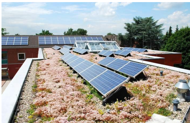
Dachbegrünung mit Photovoltaikmodulen (Quelle: www.optigruen.de/referenzen/solargruendach/erich-kaestner-schule-langenfeld/ )
