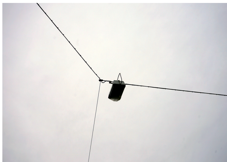
Jahnplatz Bestand - Seilleuchte. Foto: EHL
