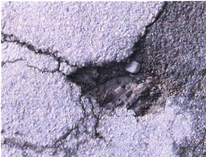
Abbildung 2 typische Ausmagerrung der Bit. Befestigung.
