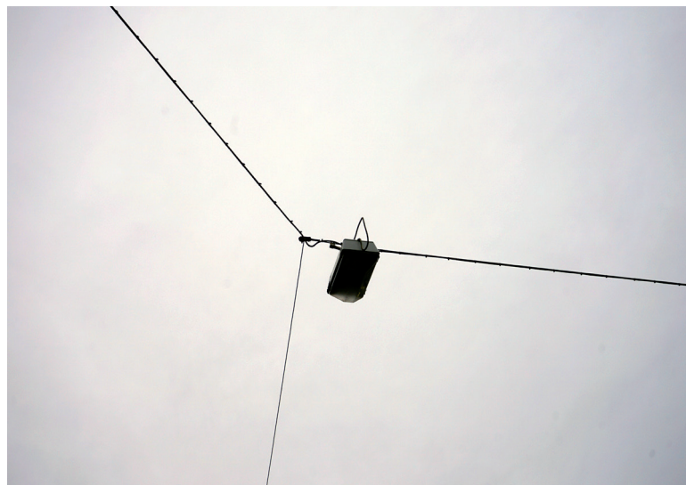
Jahnplatz Bestand - Seilleuchte. Foto: EHL
