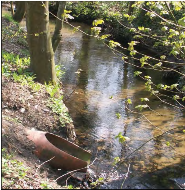
Einleitung von Niederschlagswasser in den Dalkebach
