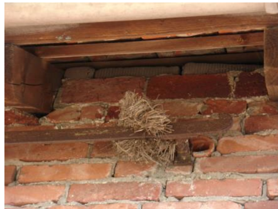
altes Vogelnest, Spaltenverstecke zwischen Mauerwerk und Dach sowie Einflugmöglichkeit an einem Nebengebäude auf dem Grundstück Hellfeld Nr. 49
