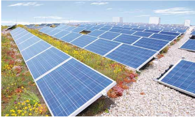
Dachbegrünung mit Photovoltaikmodulen (Quelle: OPTIGRÜN 2010)
