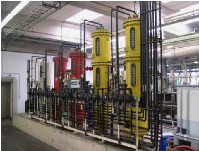
Abwasserbehandlungsanlage einer Galvanik
