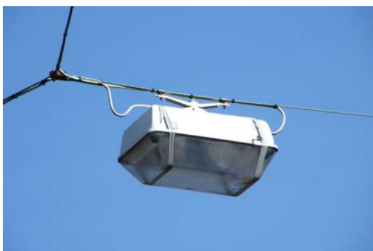
Siteco, großer Klassiker, z. B. mit SHX (Austauschleuchtmittel) 210 W
